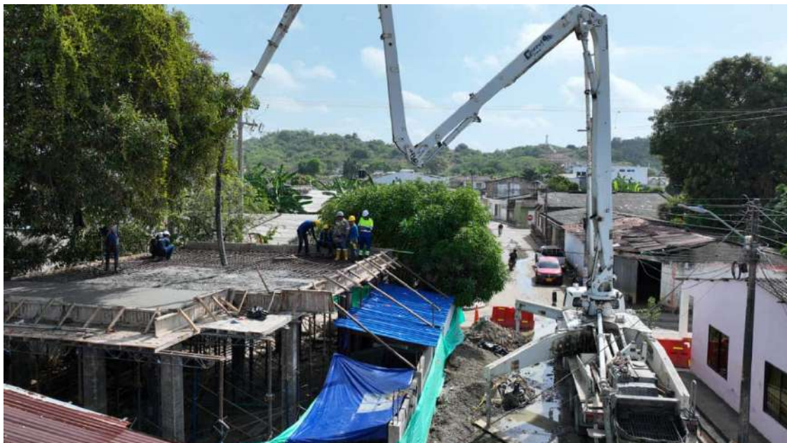
Imagen - estación de aguas residuales en Ciénaga de Oro
